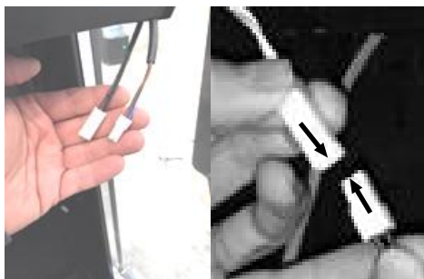
Abb. 8: Kabel verbinden LED-Balken
